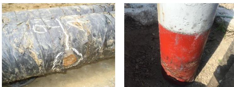
圖 1 長途管線腐蝕：埋地管段腐蝕(左)，出入土界面腐蝕(右)。
