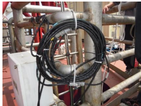
(b) 導線未劣化，接頭已嚴重銹蝕
