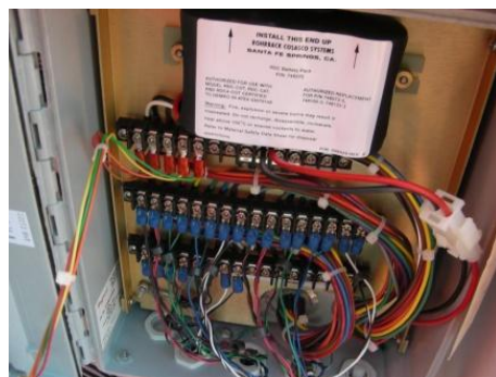
(c) RDC4 內部接頭、導線狀況良好
