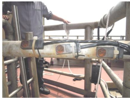
(a) 平台上腐蝕探針銹蝕狀況
