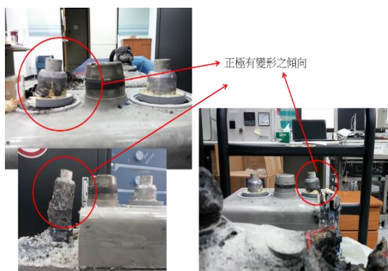
圖 4 對照組蓄電池正極雖無燒損仍有變形現象。
