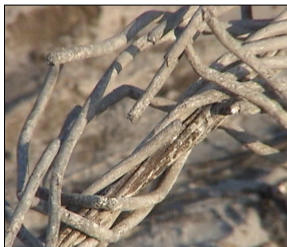
圖 2 草湖~芳苑 2 號塔~10 號塔 954 MCM (45/7) ACSR/AW 導線已嚴重腐蝕。
