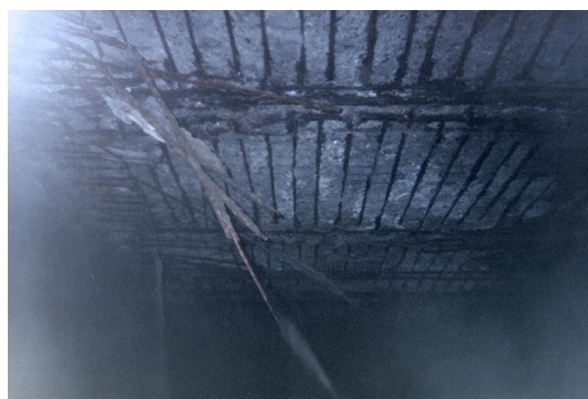
圖 4 蘇澳港#13 號碼頭 R.C.面版鋼筋腐蝕損壞之情形。
