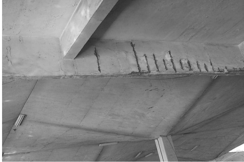
圖 1 高雄前鎮魚港鋼筋銹蝕 [7] 。
