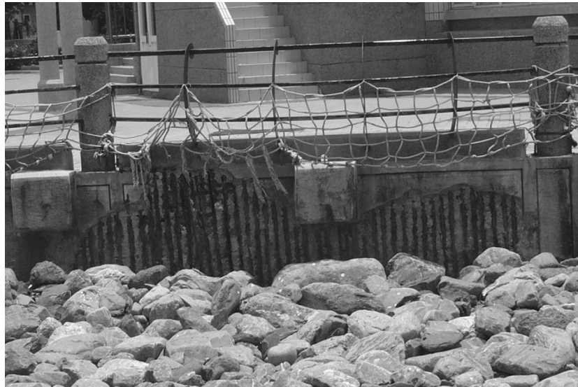
圖 2 旗津海岸公園混凝土剝落。
