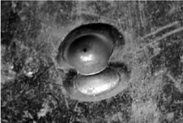
圖1. 送檢破損管線 Fig.1 Defective pipeline
